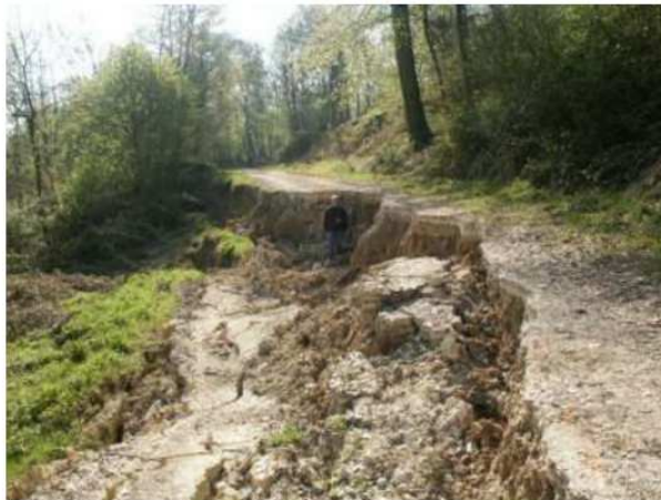
Amont du glissement : dans la forêt
