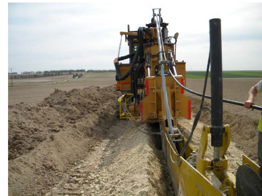
Exemple de tranchées pour le passage du câblage interne (Source : Schneider Electric)
