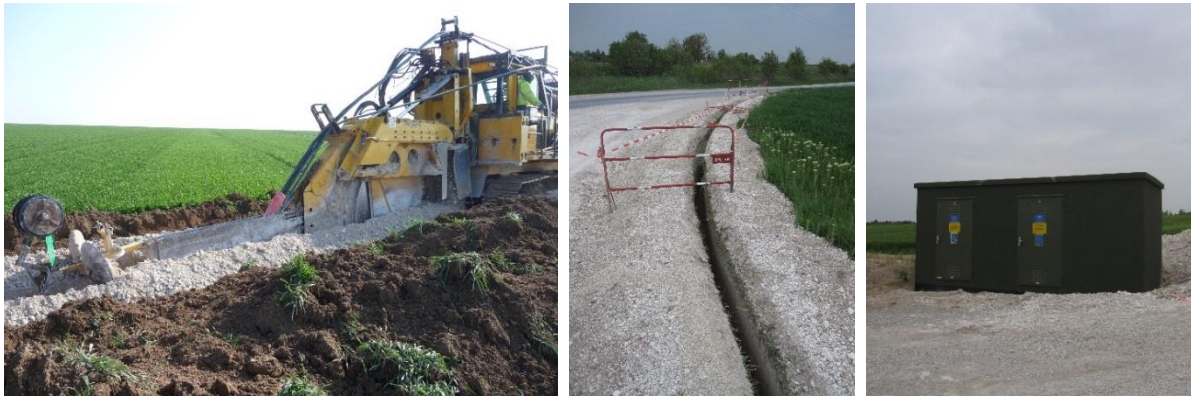
Illustration d'une trancheuse en action, d'une tranchée et d'un poste de livraison (Source : TotalEnergies).
