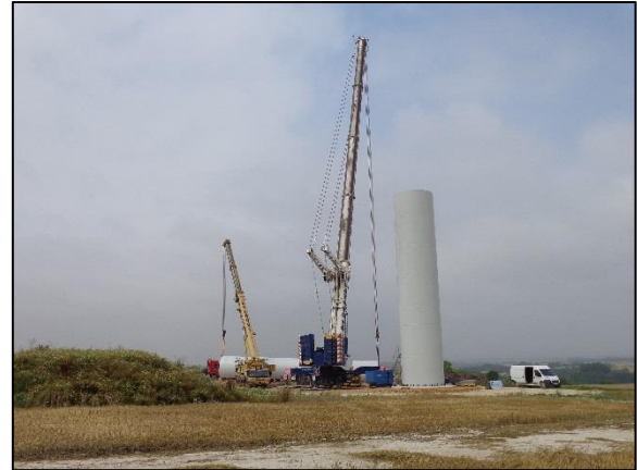
Photo 14 : Hissage de la première section de la tour (Source : documents internes à l'entreprise)
