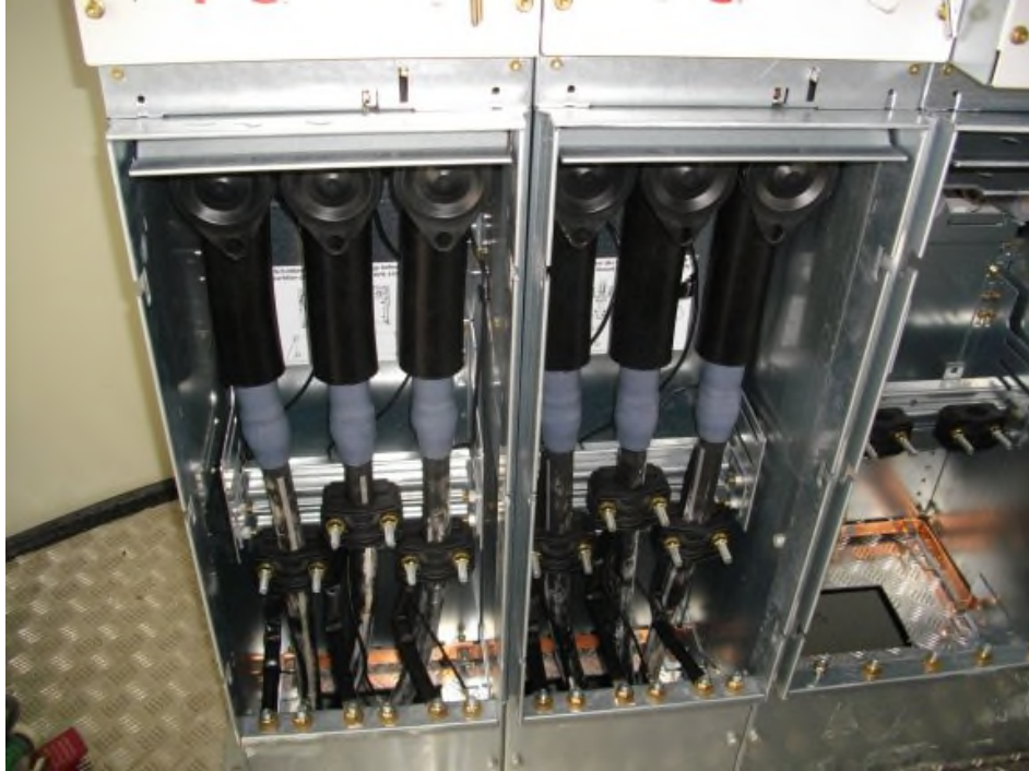
Figure 4 - Têtes de câbles isolées
