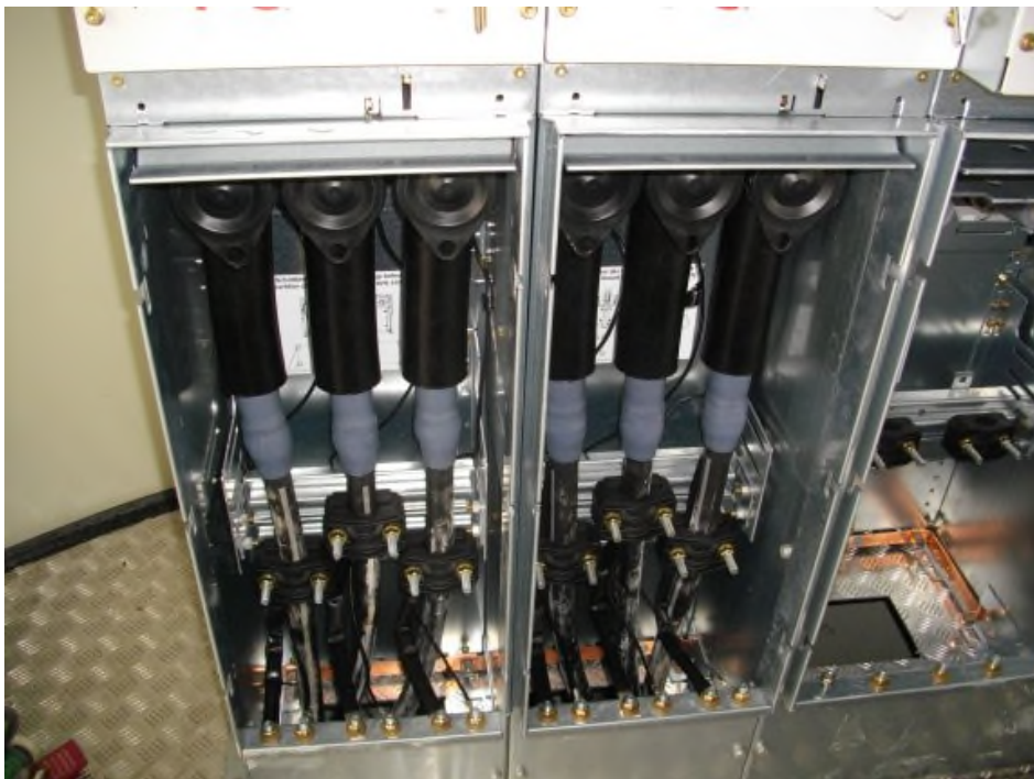
Figure 4 - Têtes de câbles isolées
