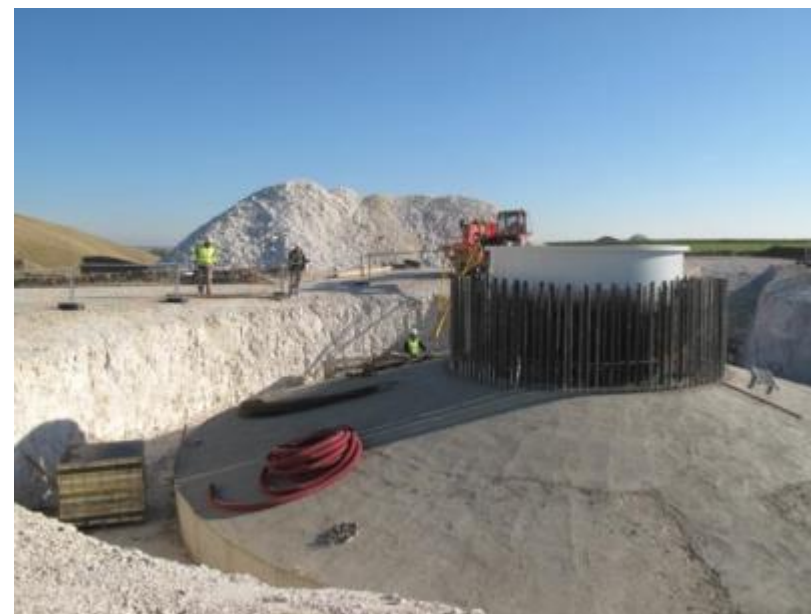
Une fois la semelle coulée la virole est fixée à la partie supérieure de la fondation
