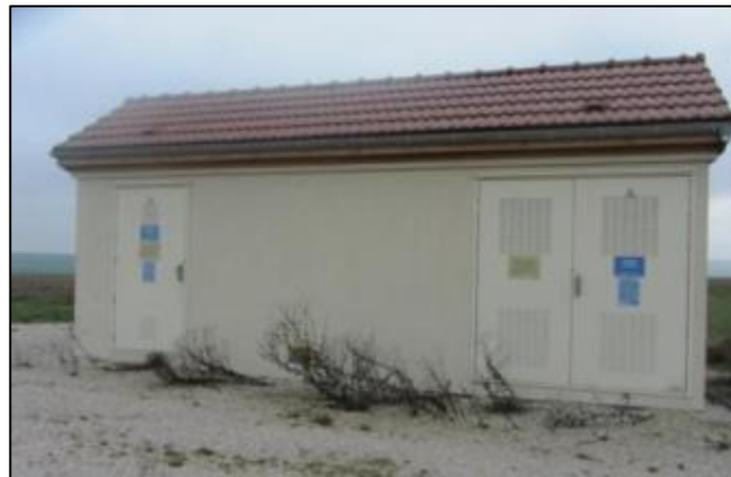
Illustration 2 : Exemple de poste de livraison (parc des 4 Vallées)
