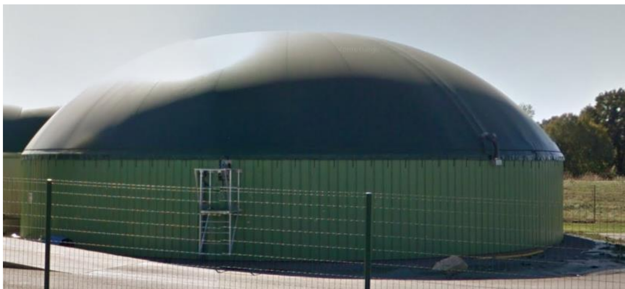
Figure 11 : Exemple de post-digesteur (site Agri-Bio-Méthane - 85)
