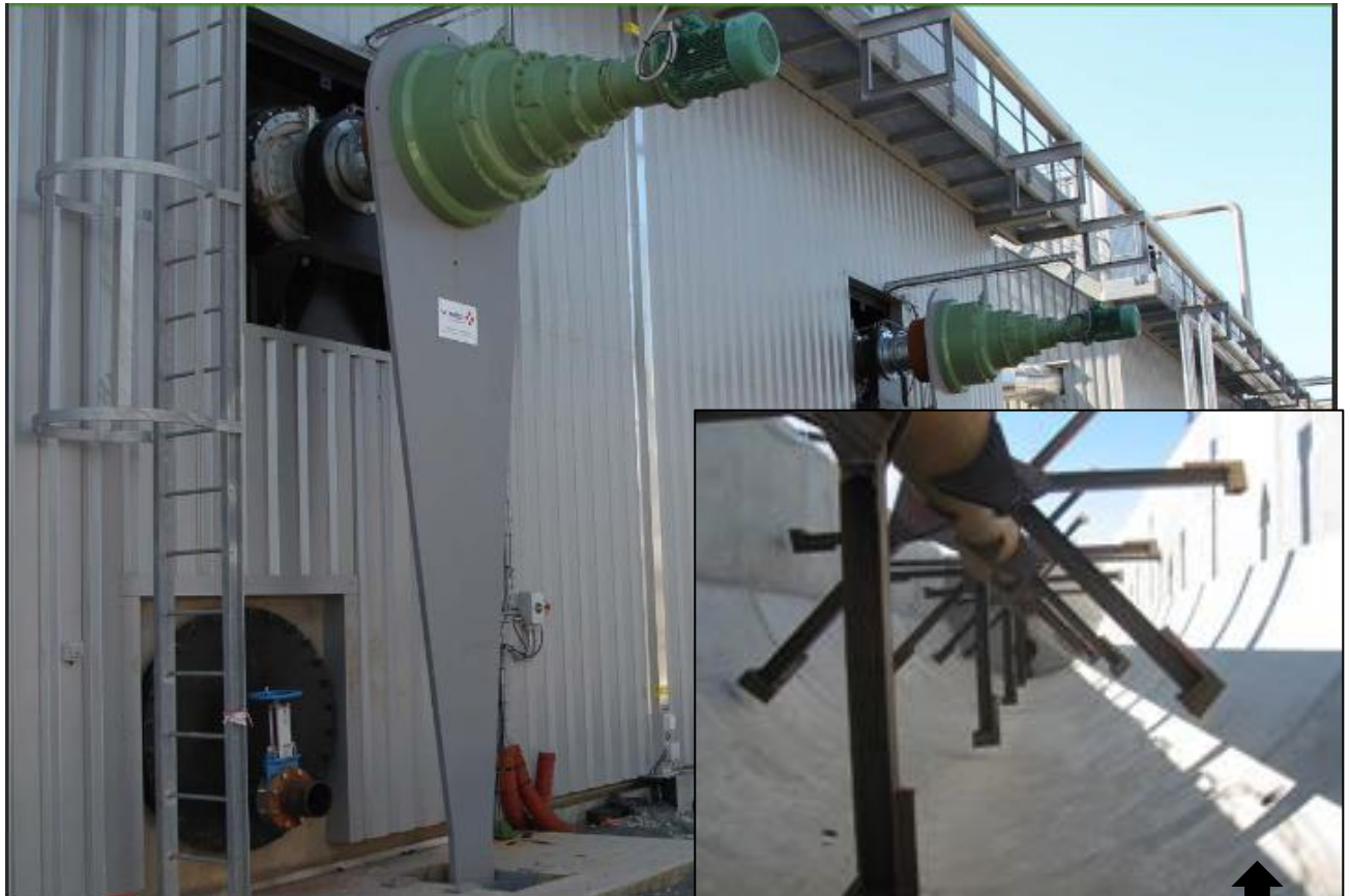
Intérieur d'un digesteur KOMPOGAS® Axe malaxeur - Photothèque VINCI
