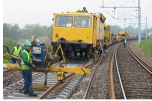
Longs Rails soudés sur traverses béton
