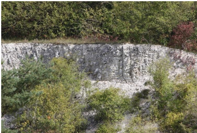
Ci-contre, vue sur un des éboulis crayeux résiduels présent au niveau de l'ancienne carrière du Mont Favarger. Ce site est actuellement utilisé comme parcours de ball-trap – Site d'étude 2018 ©J. MIROIR-ME.
