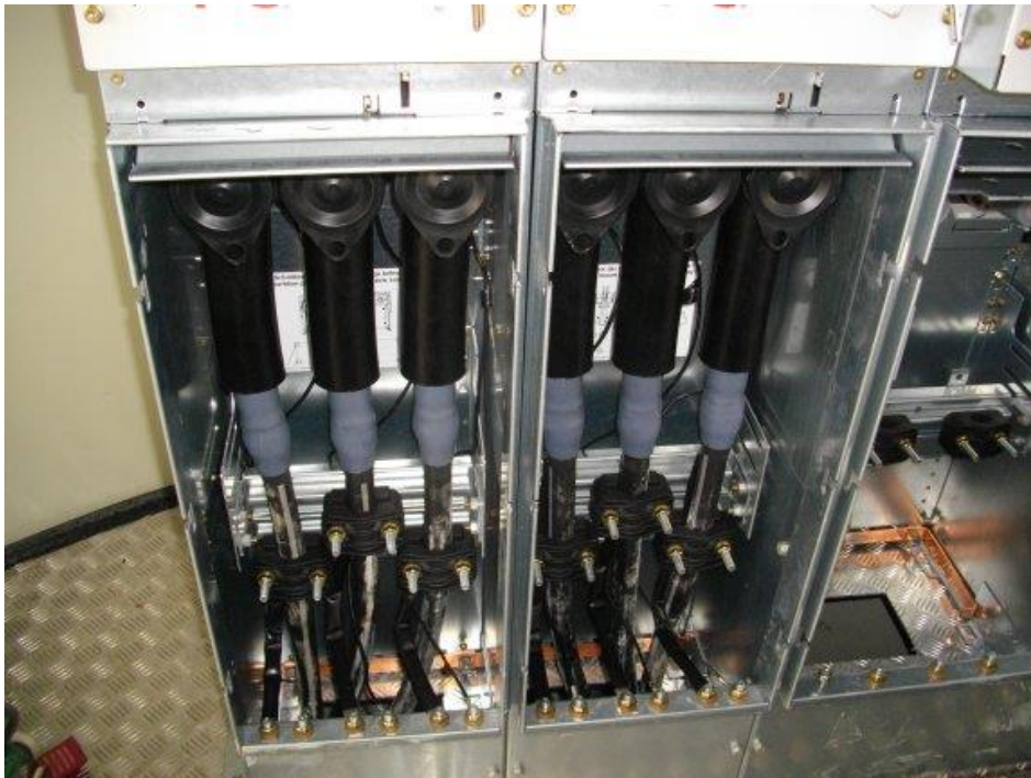
Figure 4 - Têtes de câbles isolées
