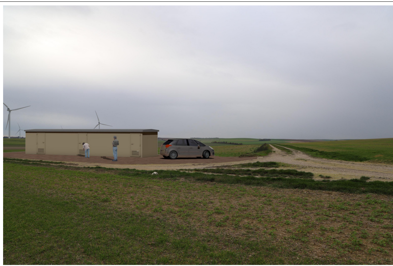
Insertion paysagère du poste 1 du Parc Eolien de La Côte Belvat II
