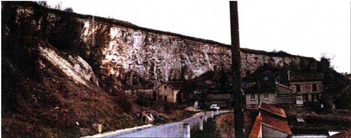
Zone à risques d'éroulement et chute de blocs sur la commune de Mareuil-sur-Ay (carrière de la Remissonne)
