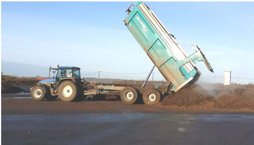
Figure 6 : Alimentation de la plateforme de stockage des boues
