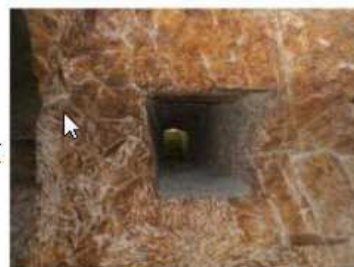
Conduit d'aération Caves Joseph-Perrier
