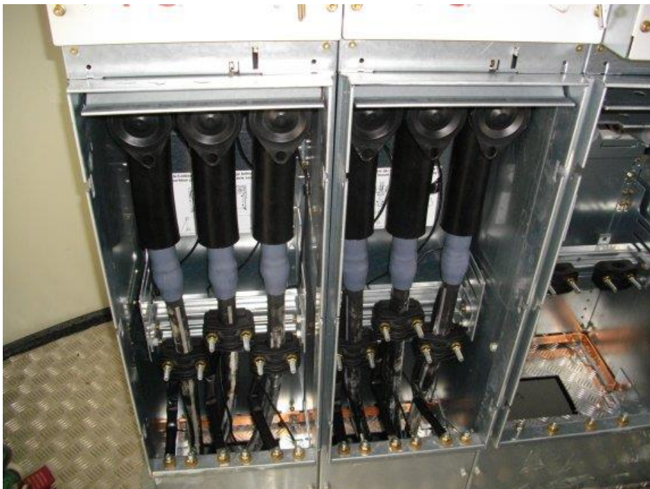
Figure 4 - Têtes de câbles isolées
